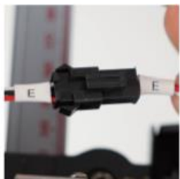
E (3PIN) → Signálny kábel detektora plameňa
